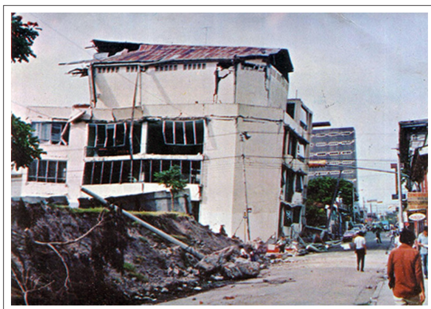
13 Edificio Tropigas. Terremoto del 10 de octubre de 1986. http://www.flickr.com/photos/reneaguiluz/3691168496/in/photostream/ . Consultado 28/11/2009
