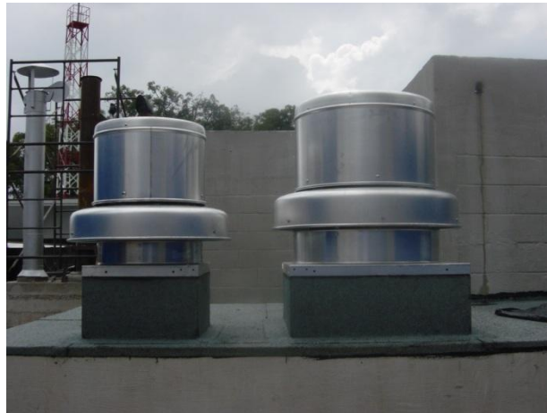
Ilustración No.60. Extractores Centrífugos de techo y pared.
