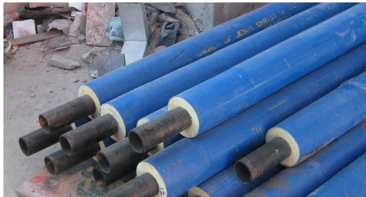
Ilustración No. 32. Tubería insulada para sistema de aire acondicionado tipo Chiller.
