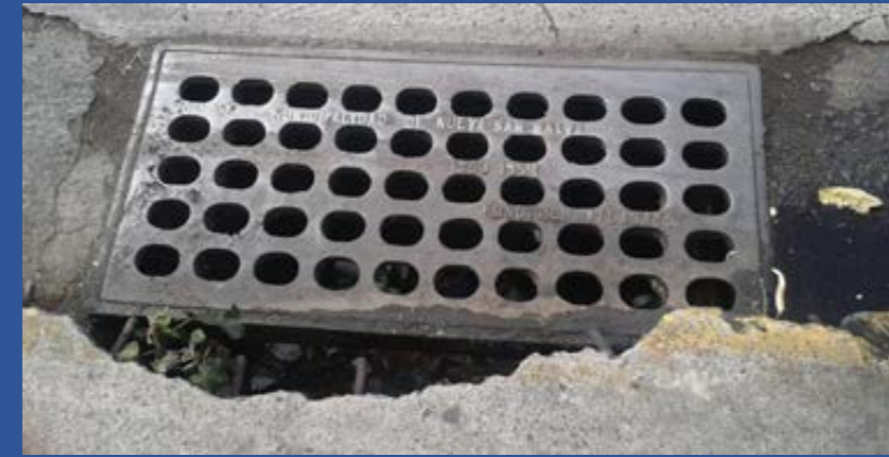
Caja Tragante obstruida por la basura y el cordón dañado
