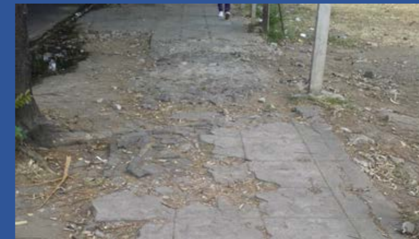
Acera dañada y arriate sin cordón, acumulación de agua, no existe caja tragante
