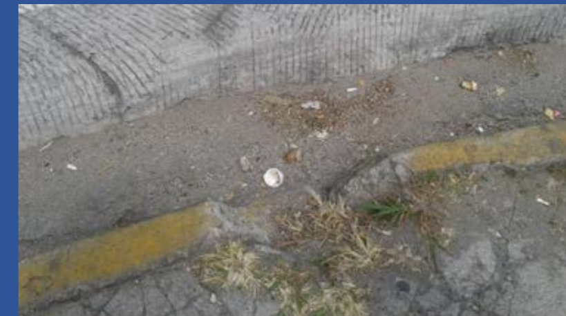
Cordón dañado entre la 6ª Avenida sur y la carretera panamericana, no existe caja tragante
