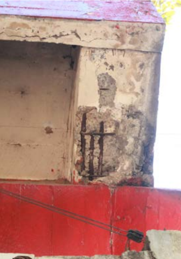
Fotografía 2. Columna 2 lateral Izquierdo.
