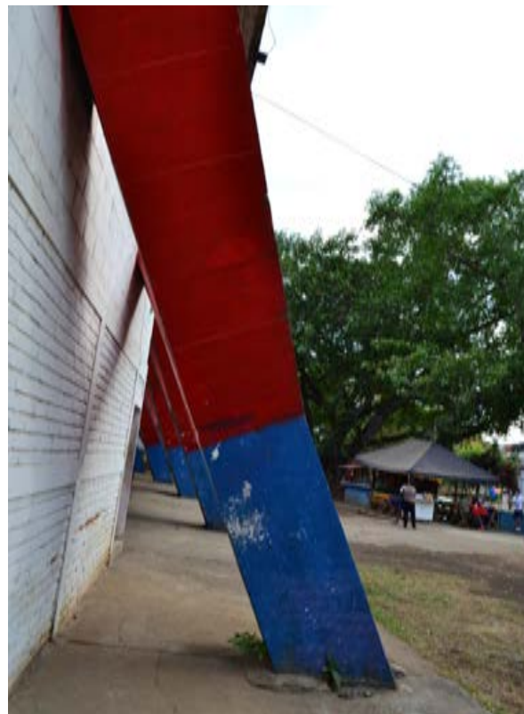
Fotografía 2. Columna 3 lateral Izquierdo.
