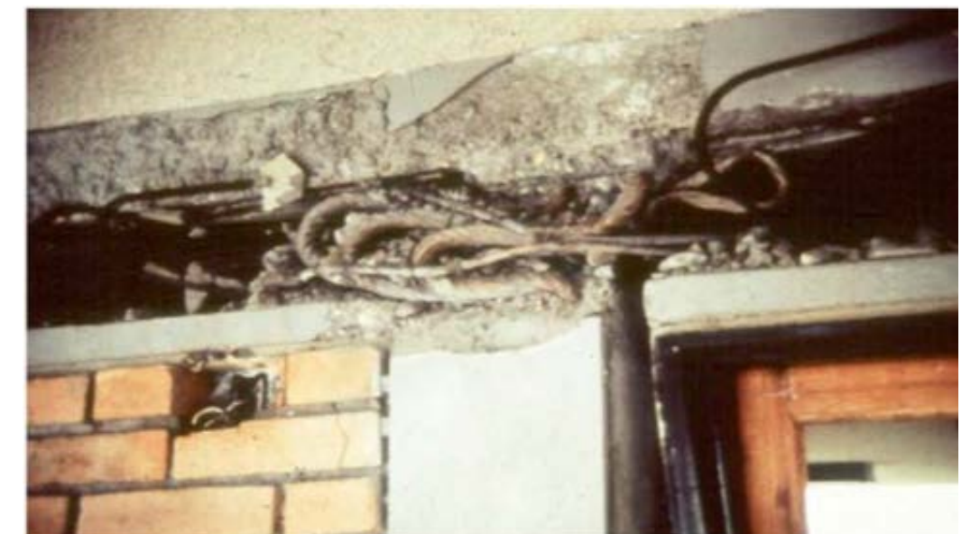
Imagen ilustrativa de ASIA de casos análogos de daños. Fuente: https://www.dropbox.com/s/qylkfc8zqabgo6b/14.%20GUIA%20INSPECCION.pdf . pag 37
