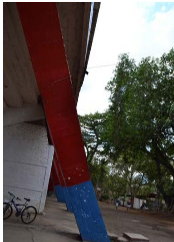
Fotografía 2. Columna 5 lateral Izquierdo.
