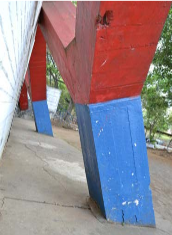
Fotografía 2. Columna 6 lateral Izquierdo.
