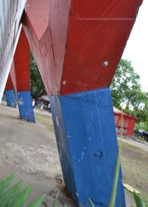
Fotografía 2. Columna 2 lateral Izquierdo.
