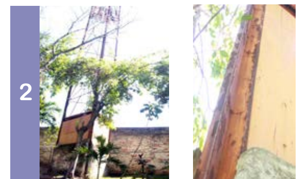
2 Vista base de las torre de iluminación.
