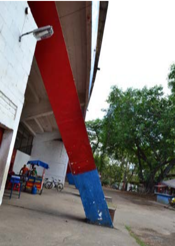
Fotografía 2. Columna 4 lateral Izquierdo.
